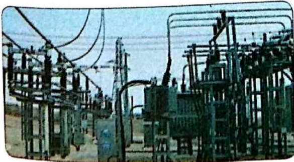
2. محطة توليد الكهرباء.
