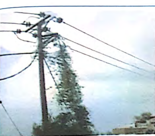
2 - الشجرة تلامس أسلاك الشبكة الكهربائية
