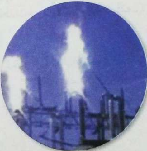
حريق في أسلاك توصيل
